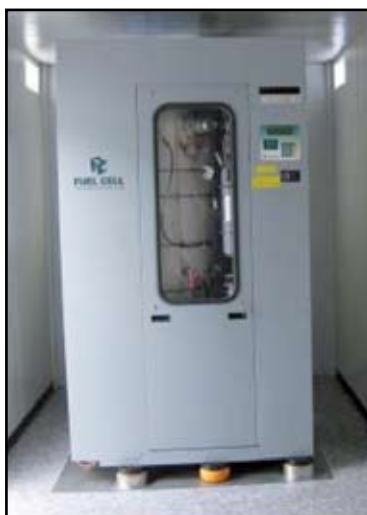
Pila SOFC de 5 kW. Proyecto BIOSOFC. Fuente: BIOGAS Fuel Cell
